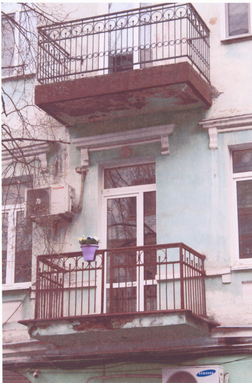
Вул. Ігорівська, 12. Будинок житловий. Головний (північний) фасад. Балкони 2 та 3 поверхів. Фото К. Денисова 2014 р.
