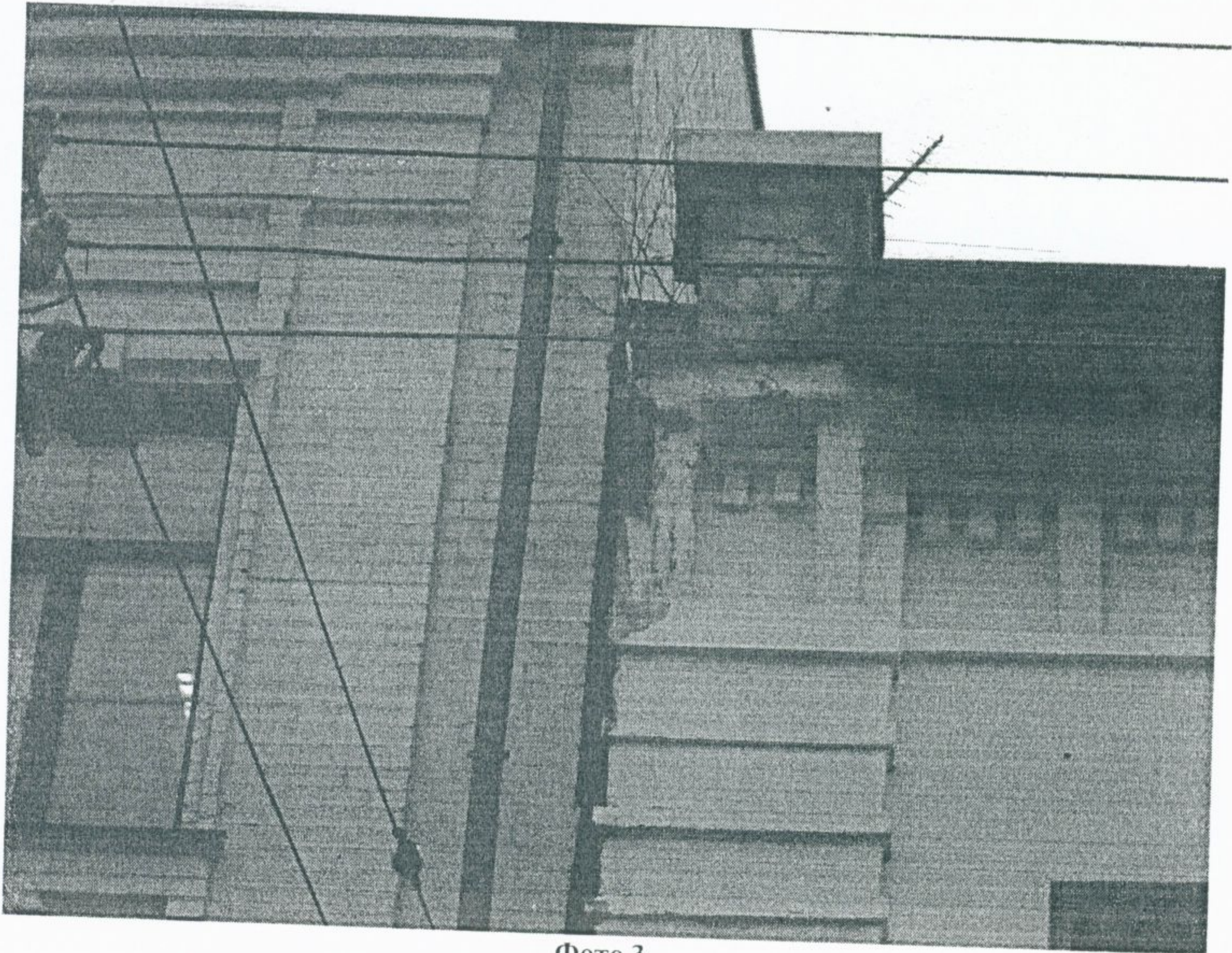
Фото 3. «Готель», 1873 р., 1873 р. (перебудова), 1950 (надбудова) вул. Ігоревська, 12 Пошкоджена ділянка при дахового карнизу. Акт від 18.12.2014 № 69-тс
