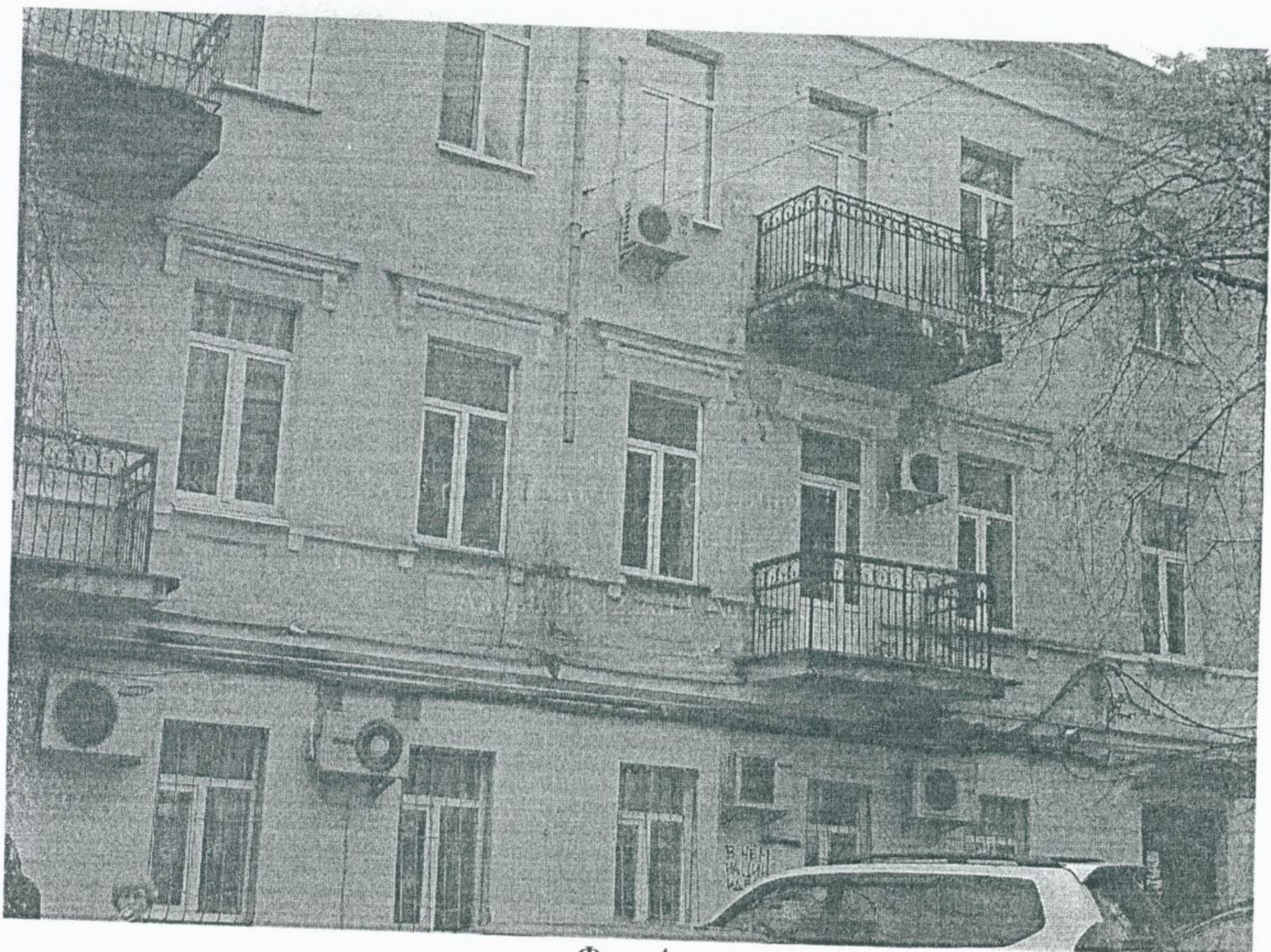
Фото 4. «Готель», 1873 р., 1873 р. (перебудова), 1950 (надбудова) вул. Ігоревська, 12 Пошкоджена ділянка водозливної системи. Акт від 18.12.2014 № 69-тс
